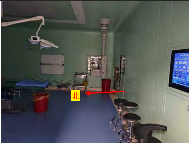
DSA 机房手术室北侧
