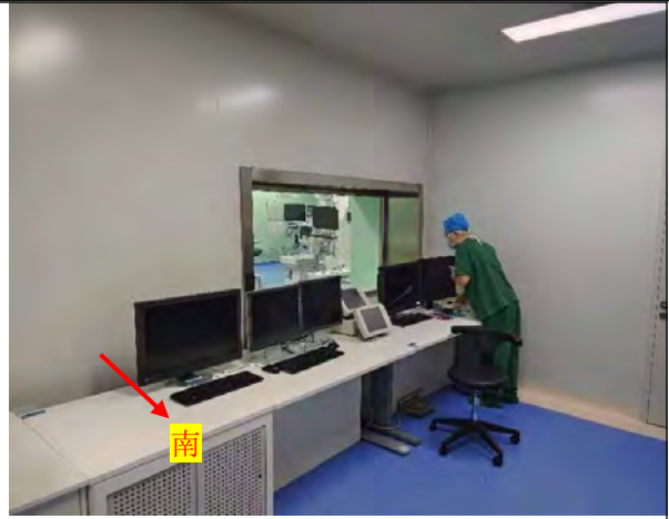
DSA 手术室南侧操作室
