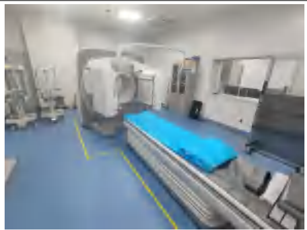
SPECT 机房扫描间内部
