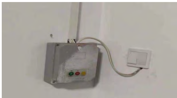
图 3-15 探伤室紧急开门按钮
