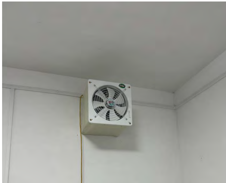
图 3-5 探伤室通风口现场照片
