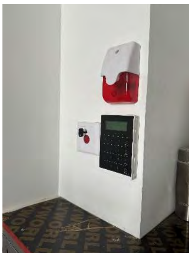
图 3-17 贮源库内入侵报警装置现场照片
