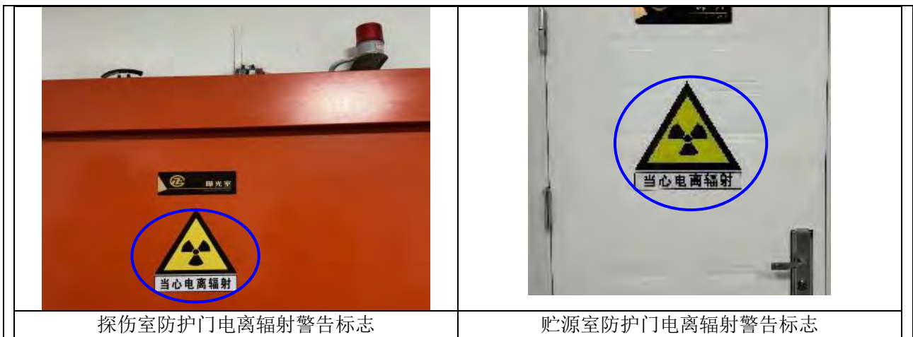
图 3-12 防护门电离辐射警告标志现场照片
