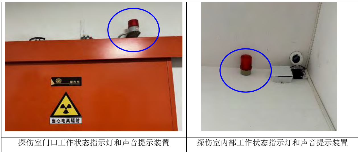
图 3-11 探伤室工作状态指示灯和声音提示装置现状照片
