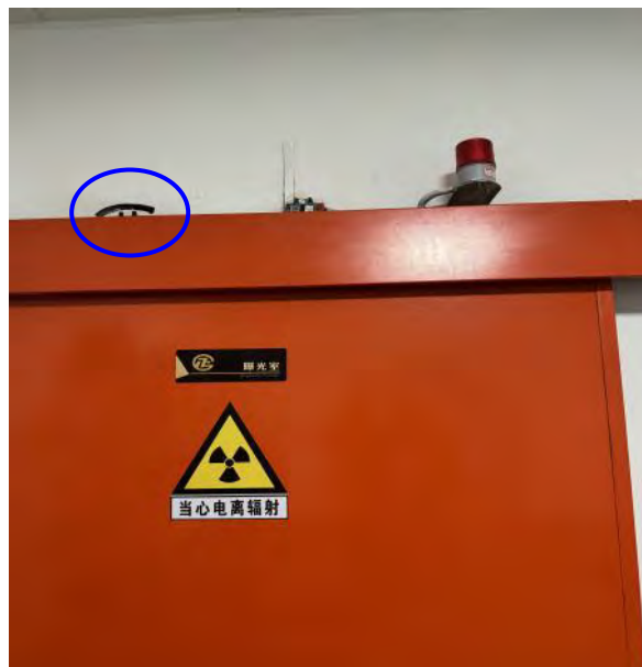
图 3-5 探伤室门-机连锁装置现状照片
