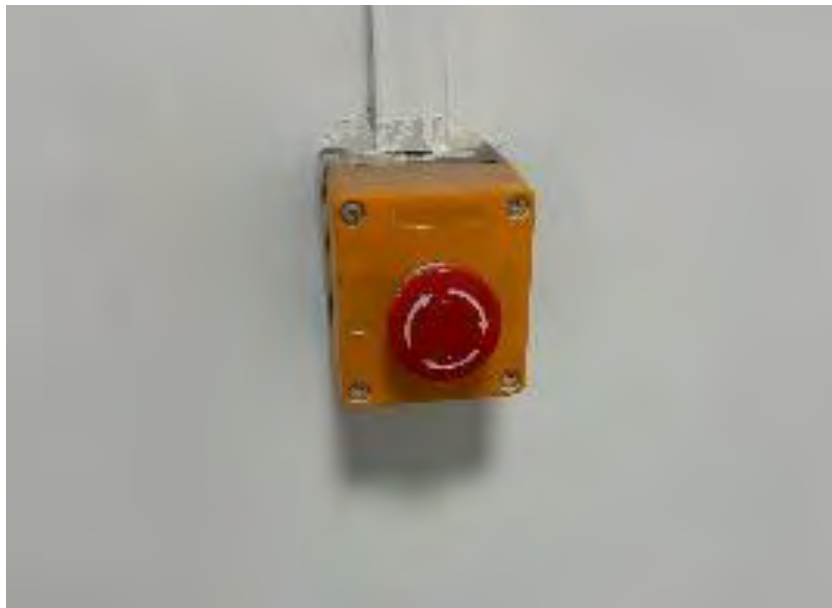
图 3-7 探伤室紧急停机按钮现场照片
