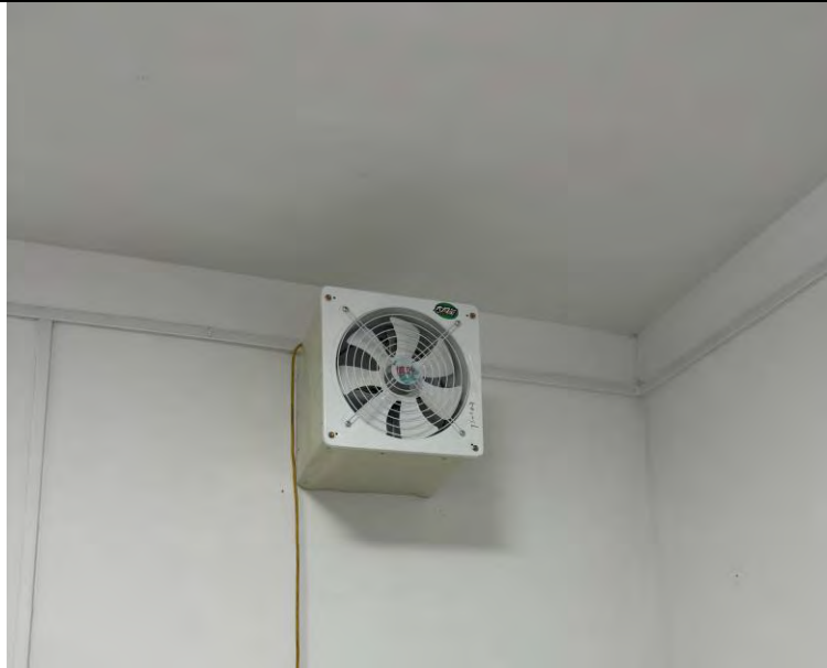
图 3-4 探伤室通风口现场照片
