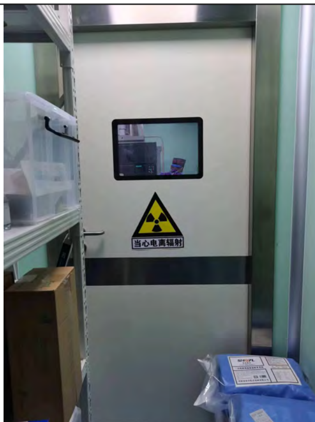
导管间防护门
