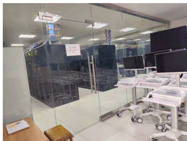
楼上（网络机房）
