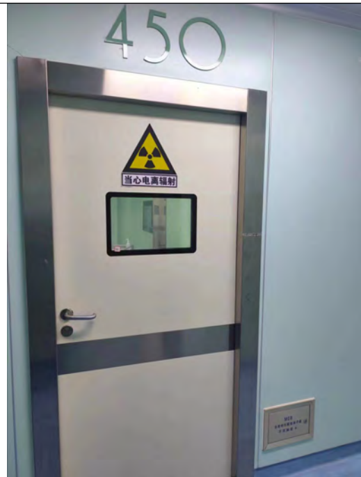
污物通道进出防护门
