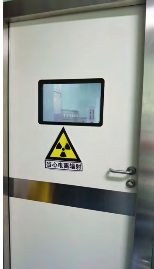
设备间防护门
