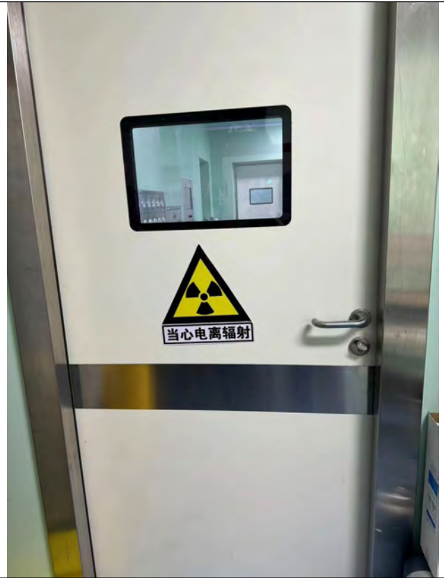
导管间防护门
