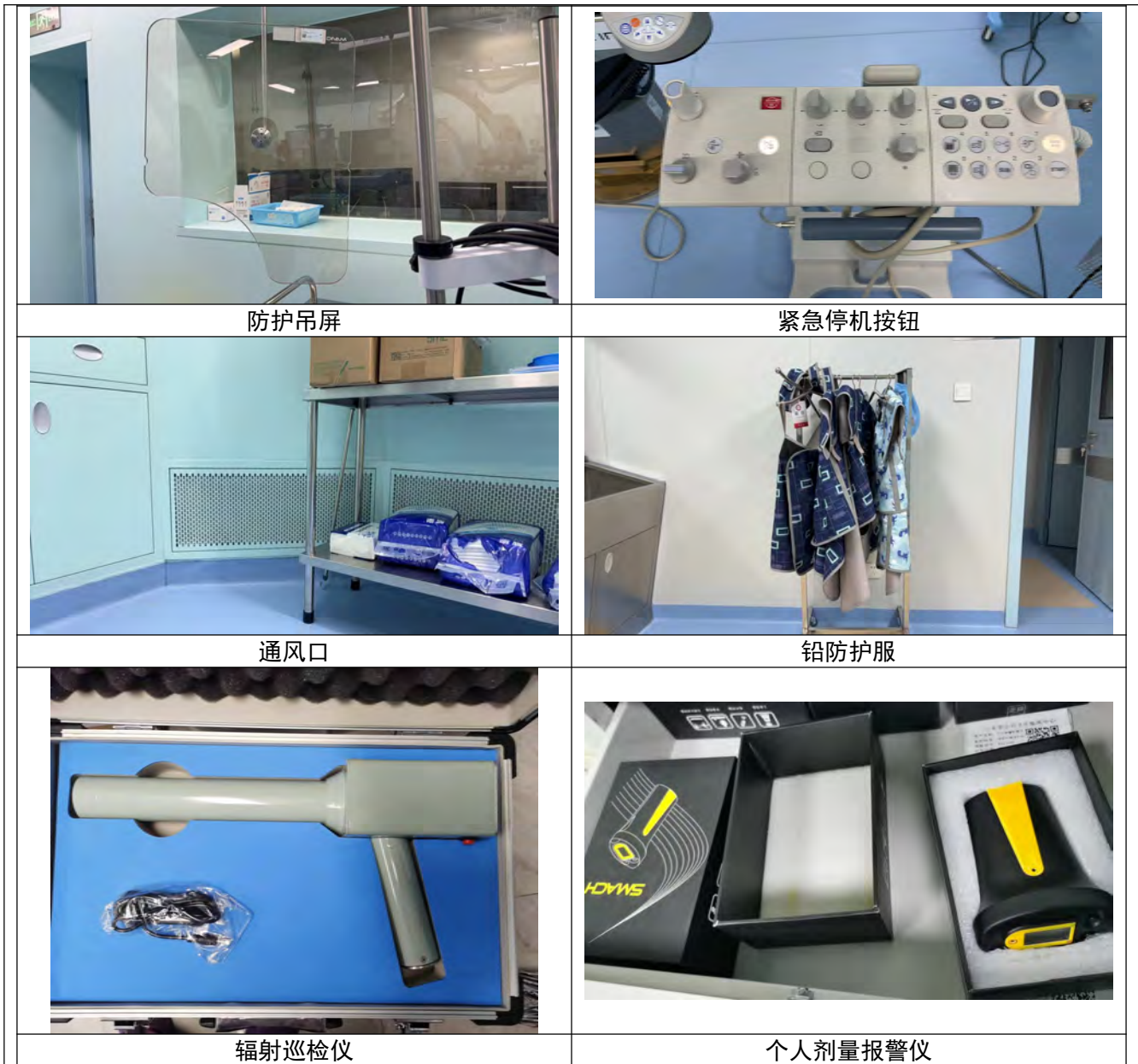
图 3-1 DSA 装置机房辐射安全与防护措施现场照片
