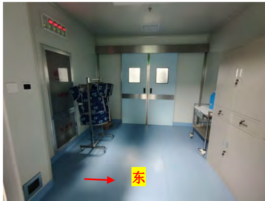
DSA 机房东侧缓冲区
