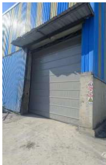
脱硫石膏棚快速堆积门
