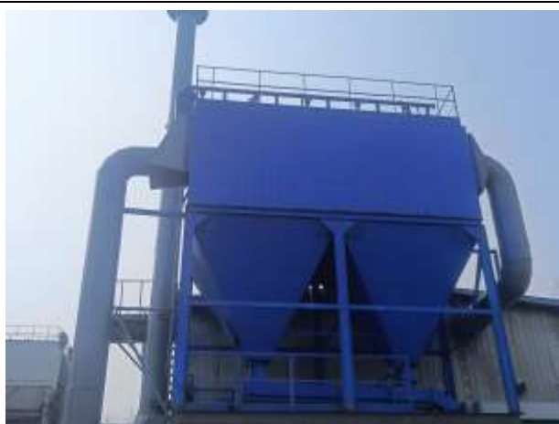
布袋除尘设施
