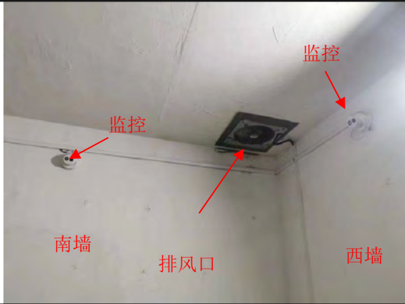
排风口及监控
